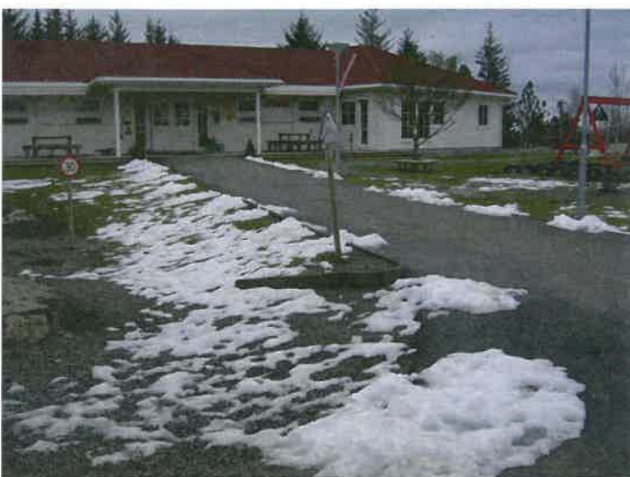
Bilde tatt fra lekebua og mot inngangsparti, på dette området ser vi grus og at grunnen ikke er vannrett.
